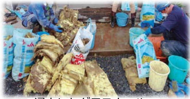
浸水したグラスウール
