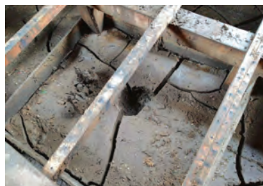
床下にたまった泥（写真③）
