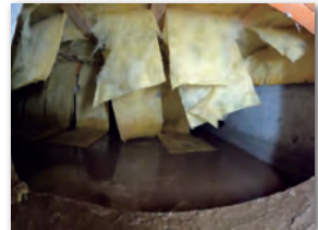
写真③ 床下の断熱材が水を含んではがれ落ちている
