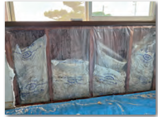
カベの裏側の断熱材がぬれたまま残っている状態
