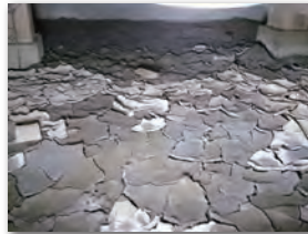
写真② 乾燥した汚泥も異臭の原因になる
