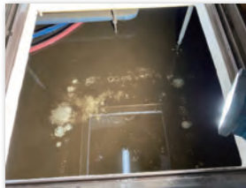
写真⑤ 排水口がなく水がたまっている
