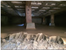
写真① 床下に泥がたまっている
