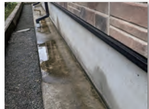
写真⑥ 雨が降っていないのに水がにじみ出ている
