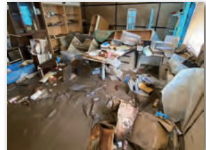
室内の被害状況も撮っておく
